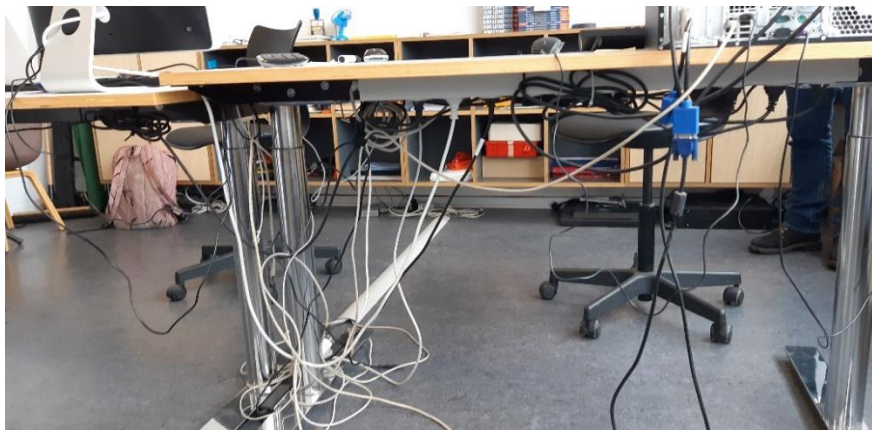
Fig.26. Løse kabler skal også undgås i lærerforberedelse.
