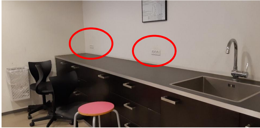
Fig. 11+12+13. Strømuttag monteret i væg eller i bordplade mindsker risikoen for at el-kedler, PC'er og andre apparater trækkes på gulvet.
